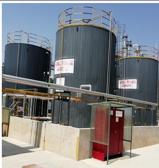
碳酸二甲酯罐区
