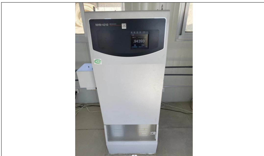
图 4.2-5 废水在线监测仪安装情况
