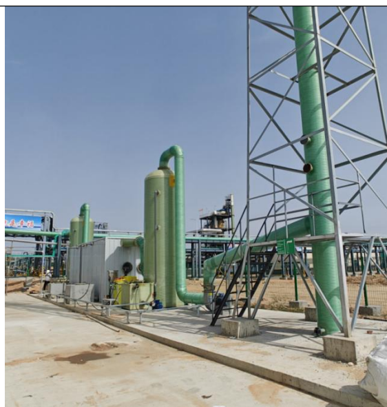
废气处理设施
