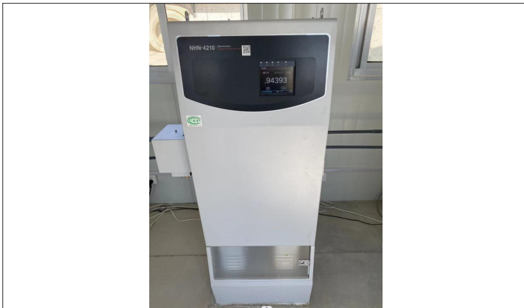
图 4.2-5 废水在线监测仪安装情况
