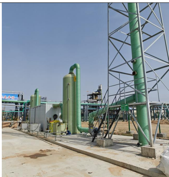
废气处理设施
