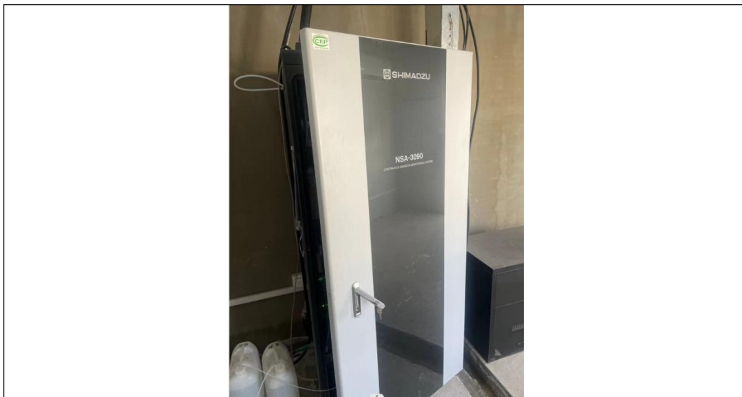
图 4.2-7 焚烧炉在线监测仪安装情况
